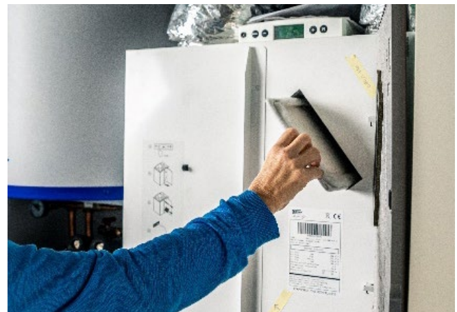
Warmteterugwinning (WTW) op ventilatielucht
