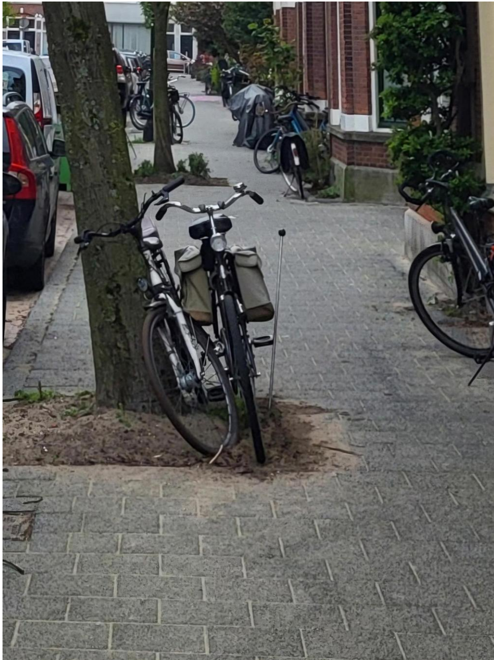
Nieuwe bestrating, geen opdruk zichtbaar, wel vermoeden van wortelschade.
